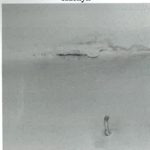
Praskliny v kuchyni
